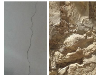
ظهور التشققات نتيجة للرطوبة الصاعدة من التربة.
