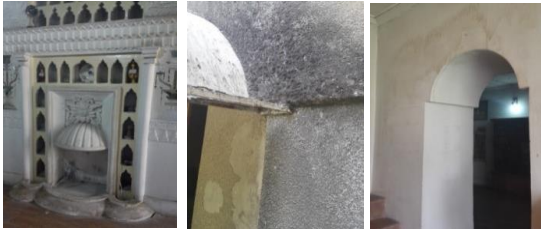
تعفن المواد نتيجة لظاهرة التكاثف (الفرق بين درجة حرارة الداخل والخارج)
