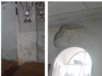
ذوبان مادة الجص نتيجة للرطوبة الصاعدة من التربة وكذلك بسبب التكاثف (الفرق بين درجة حرارة الداخل والخارج)
