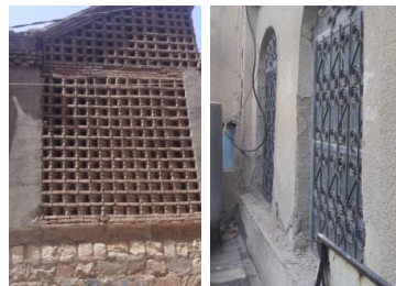
تآكل المواد (الحجر والطابوق) نتيجة للرطوبة الصاعدة من التربة وكذلك الأمطار الحامضية.
